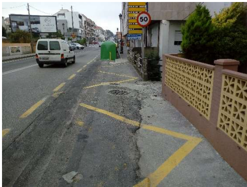
Tramo de acera sin continuidad
