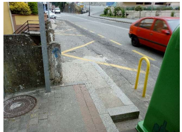
Tramo de acera sin continuidad
